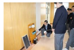
＜写真8 電源システム 実演の様子＞
